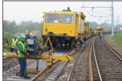
Longs Rails soudés sur traverses béton
